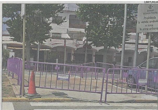
Una de les voreres del municipi que guanyaran en accessibilitat.
