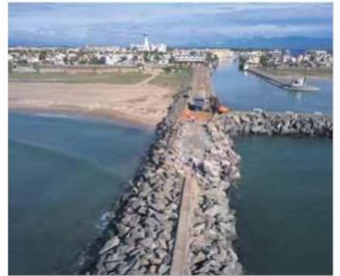
Els treballs que han començat aquesta setmana a l'entrada de la marina d'Empuriabrava ■ EPA
