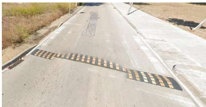
Exemple de pas de vianants rebaixat sense connexió i falta de pintura / Font: Google Maps
