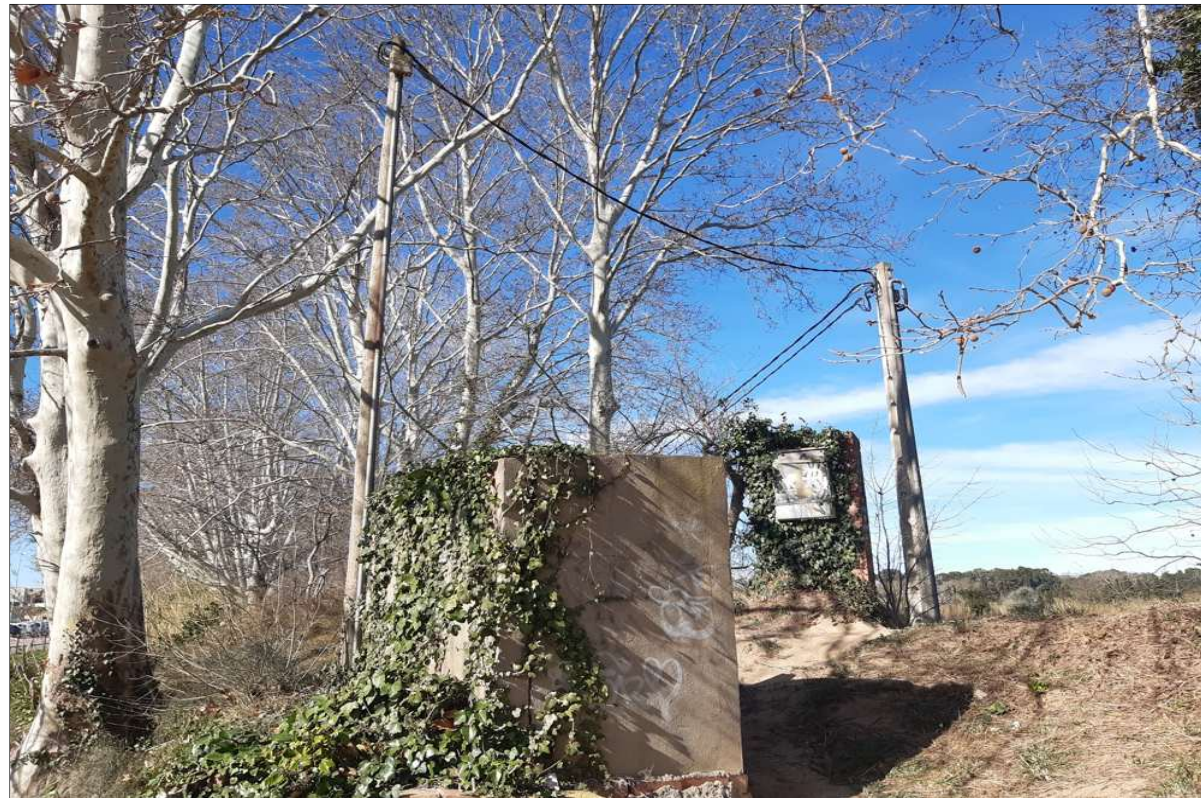
Figura 9. Punt on l'estesa elèctrica de baixa tensió surt de l'àmbit del PAE i fineix en una construcció d'obra junt al pont de Sant Francesc.
