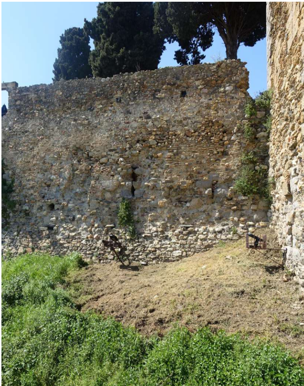
Detall de la vessant nord, especialment afectada a la part superior en contacte amb el portal
